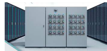
蓄電池監視システム
