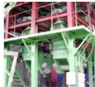
石こうボードリサイクルプラント
